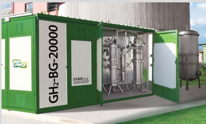
Bilden visar en anläggning som Metacons dotterbolag Helbio levererade 2006 till en kommunal reningsanläggning för omvandling av biogas till el och värme.
